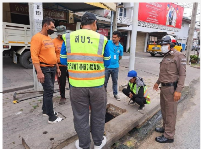
เมื่อวันที่ 4 มีนาคม 2567 เวลาประมาณ 10.00น. เจ้าหน้าที่ตำรวจจราจรสน.บางเสาธงได้ร่วมกับเจ้าหน้าที่กรมทางหลวงชนบททำการปรับปรุงระบบท่อระบายน้ำบริเวณแยกบางแวกตัดราชพฤกษ์
